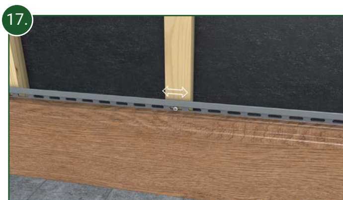
17. Die Verschraubung der Fassadenprofile mit der Traglattung erfolgt mittig durch die in den Federbereichen eingebrachten Langlöcher mittels der Fassadenschrauben.
